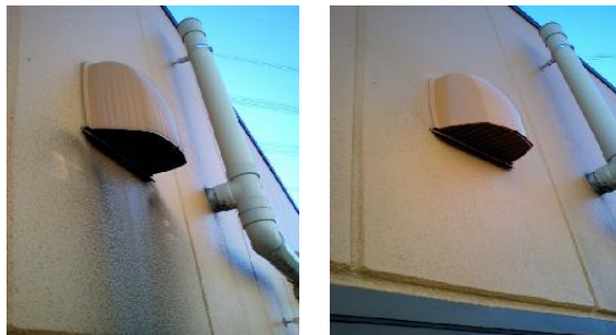
換気扇 排気ダクト
